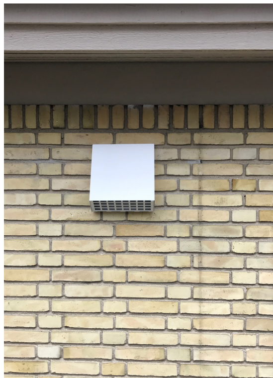
Her ses installationen på ydermuren, hvor stormskærmen sikrer det nødvendige flow af friskluft og forhindrer trækgener.
